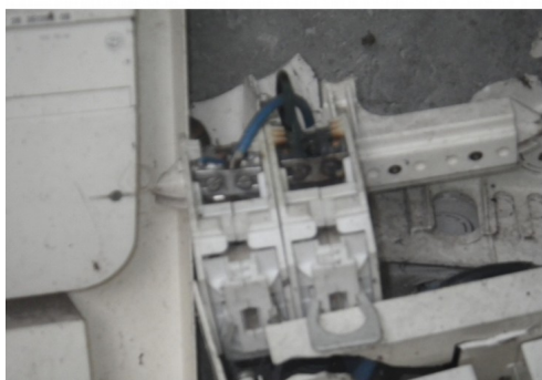
Des branchements électriques dangereux.
